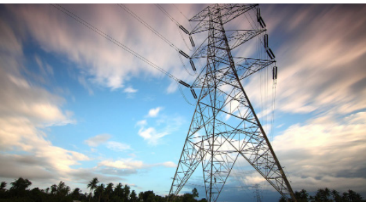
Chute de poteau
